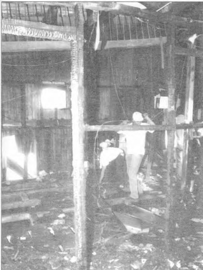
Otro aspecto de la destrucción causada por el incendio del martes 25 de julio de 1989.
