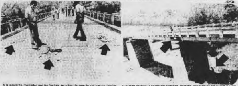
A la izquierda, marcados por las flechas, se notan claramente los huecos dejados por las explosiones en el puente de Ocotál, mismo que los terroristas somocistas quisieron destruir la noche del domingo. Derecha, panorámica del puente y lugar donde colocaron las cargas. (Fotos: Vargas).
